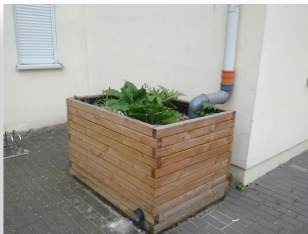
Ogród deszczowy w pojemniku przy budynku szkoły podstawowej w Warszawie. Opóźnia odpływ wody opadowej i odciąża miejską sieć kanalizacji deszczowej.
